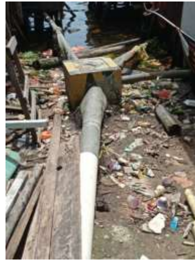
Gambar 5 Kondisi Septiktank Komunal Kolong Tengah
