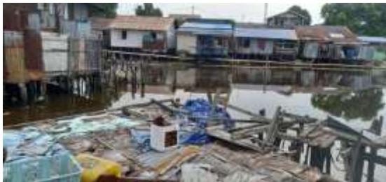
Gambar 2 Kondisi Bangunan Kolong Tengah
