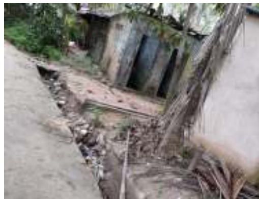
Gambar 8. Kondisi fasilitas kamar mandi
