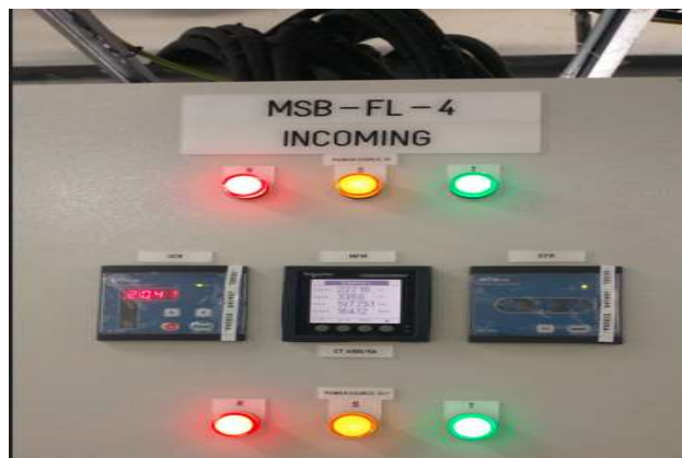
Gambar 5. Sistem proteksi terpasang di panel kubikel
