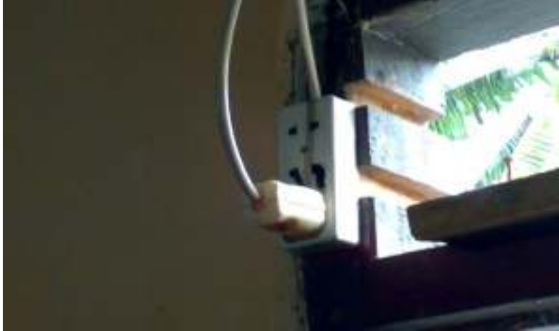
Gambar 1. Kotak Kontak yang tidak sesuai Standar SNI
