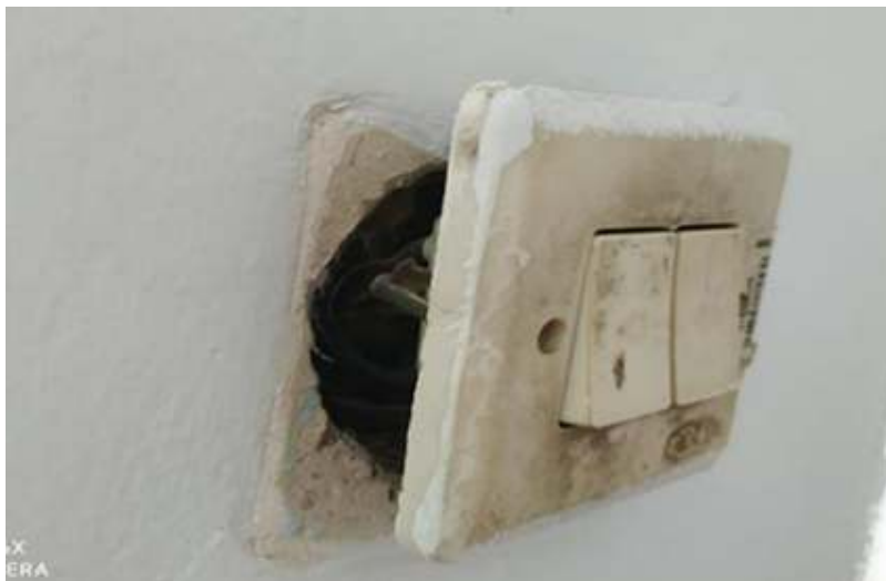
Gambar 2. Saklar Lampu Yang Terbuka
