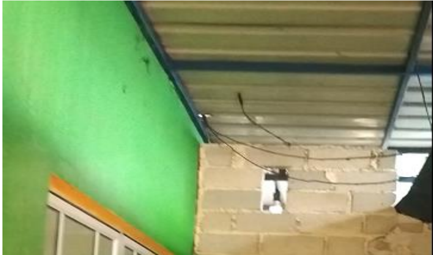
Gambar 1. Pemasangan kabel yang kurang baik
