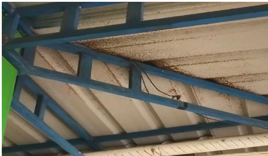
Gambar 2. Kabel Instalasi bersambungan tidak dalam pipa isolator
